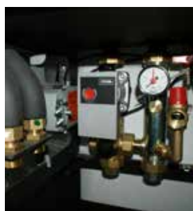
Fig.: unité d'installation hydraulique
